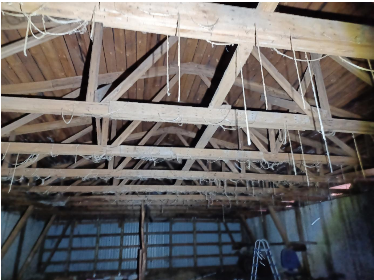
Abbildung 6: Baufälliger Zustand in der Scheune mit Kaltdach. (Foto Grünspektrum, 16.10.2025)
